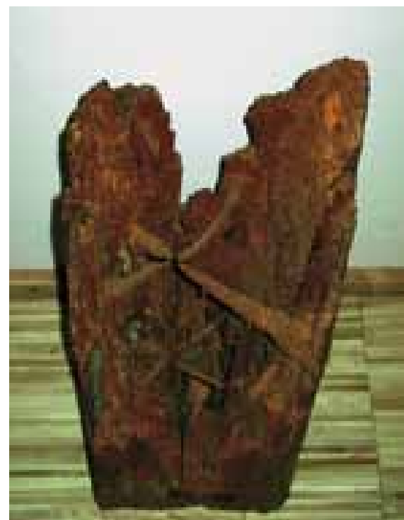
Bild 14 Zerstörung eines Tragbalkens durch den Gescheckten Nagekäfer – die Äste werden verschmäh
