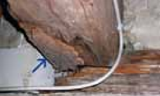
Bild 8 Fruchtkörper des Ausgebreiteten Hausporlings (Pfeil) auf der Unterseite eines Sparrenfußes
