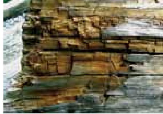
Bild 1 Braunfäule mit Würfelbruch quer zur Holzfaserrichtung
